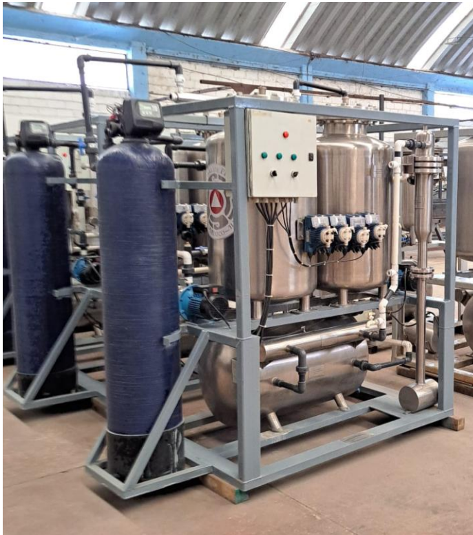
Tratamiento de Agua con algas
