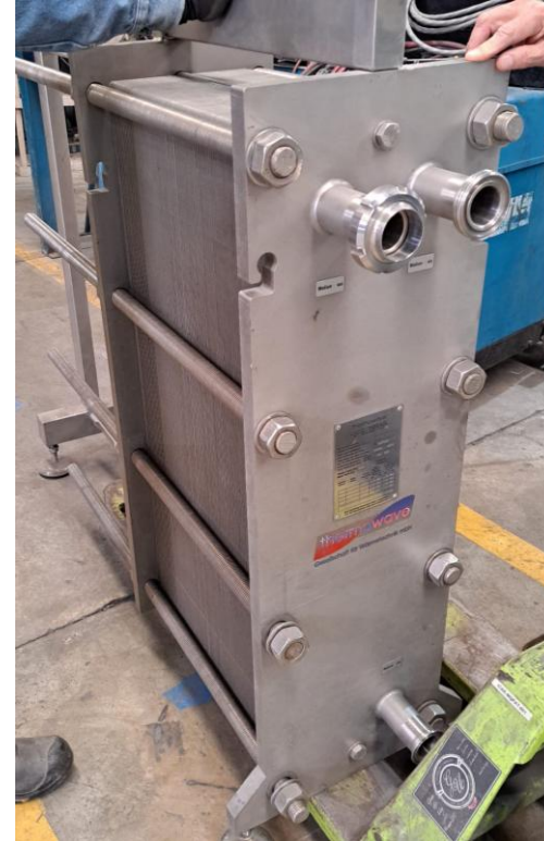
Intercambiador de calor
