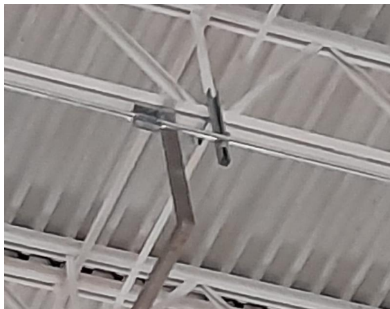
Canalización eléctrica para luminarias de zona producción 100%
