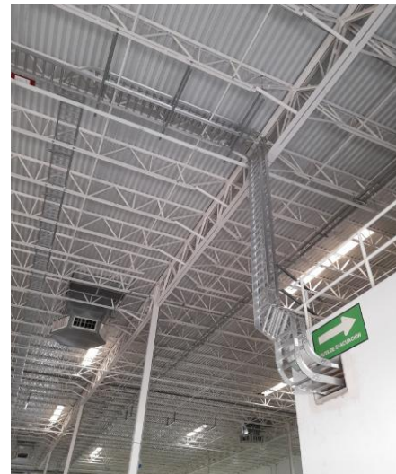
Bajada a cuarto eléctrico 100%
