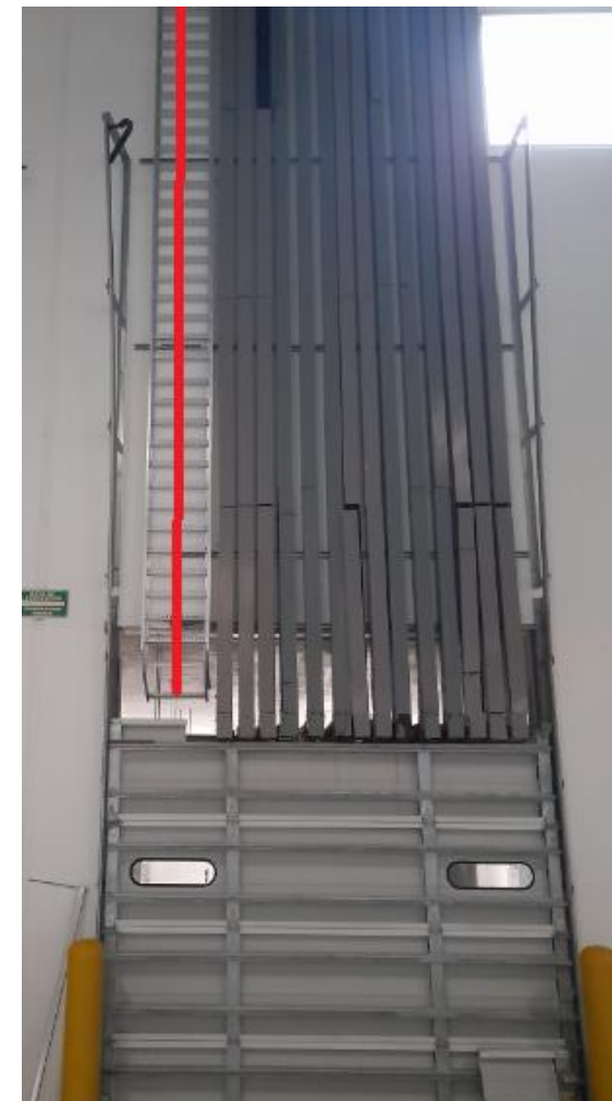
Detalle "A" Acometida eléctrica a Subestación con Vo. Bo. de CFE 100%
